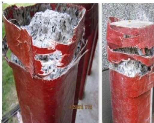
الشكل (2-35): انهيار العمود المربع المغلف بGFRP [13]
