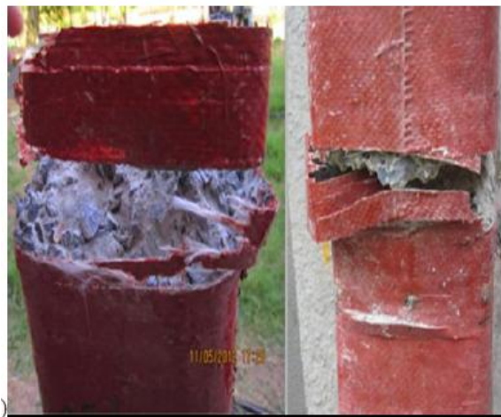
الشكل (2-36): انهيار العمود المستطيل المغلف بـ GFRP [13]
